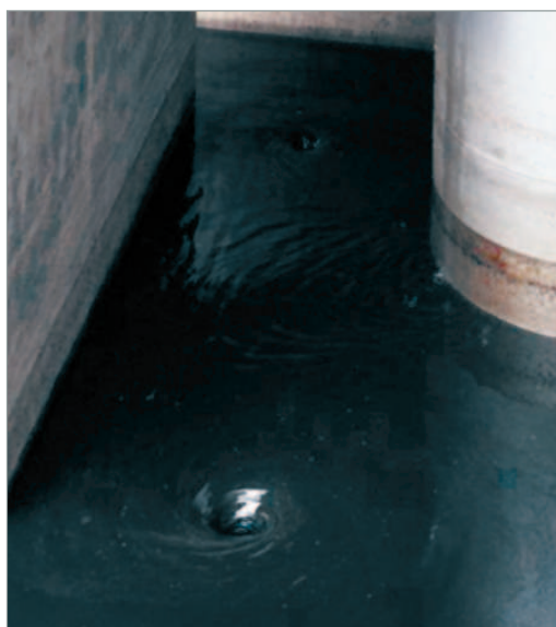
Рис. 5б Воронка в секции насосной станции
